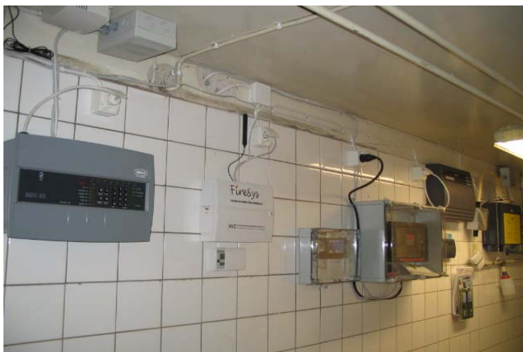
Kuva 2. Palovaroitinkeskuksia huoltotilan käytävän seinällä.
