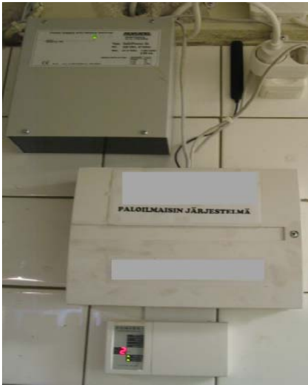
Kuva 11. Palovaroitinlaitteiston keskus, näppäimistö, antenni ja lisävirtalähde.
