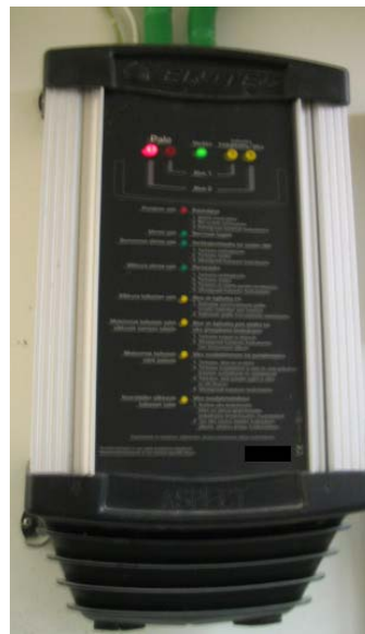
Kuva 22. Laitteiston näytteenottoilmaisin, jossa sijaitsevat toiset suodattimet.
