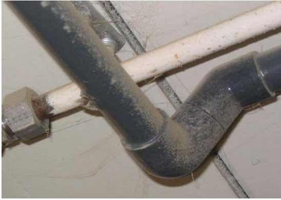
Kuva 8. Putkistoon tehty mutka,
