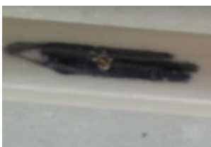
Kuva 28. Putkiston reikä on merkitty tussilla.
