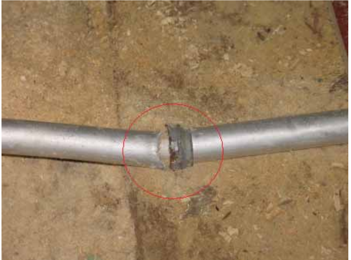
Kuva 19. Rikkoutunut suojaputki painaa suojaamaansa kaapelia.
