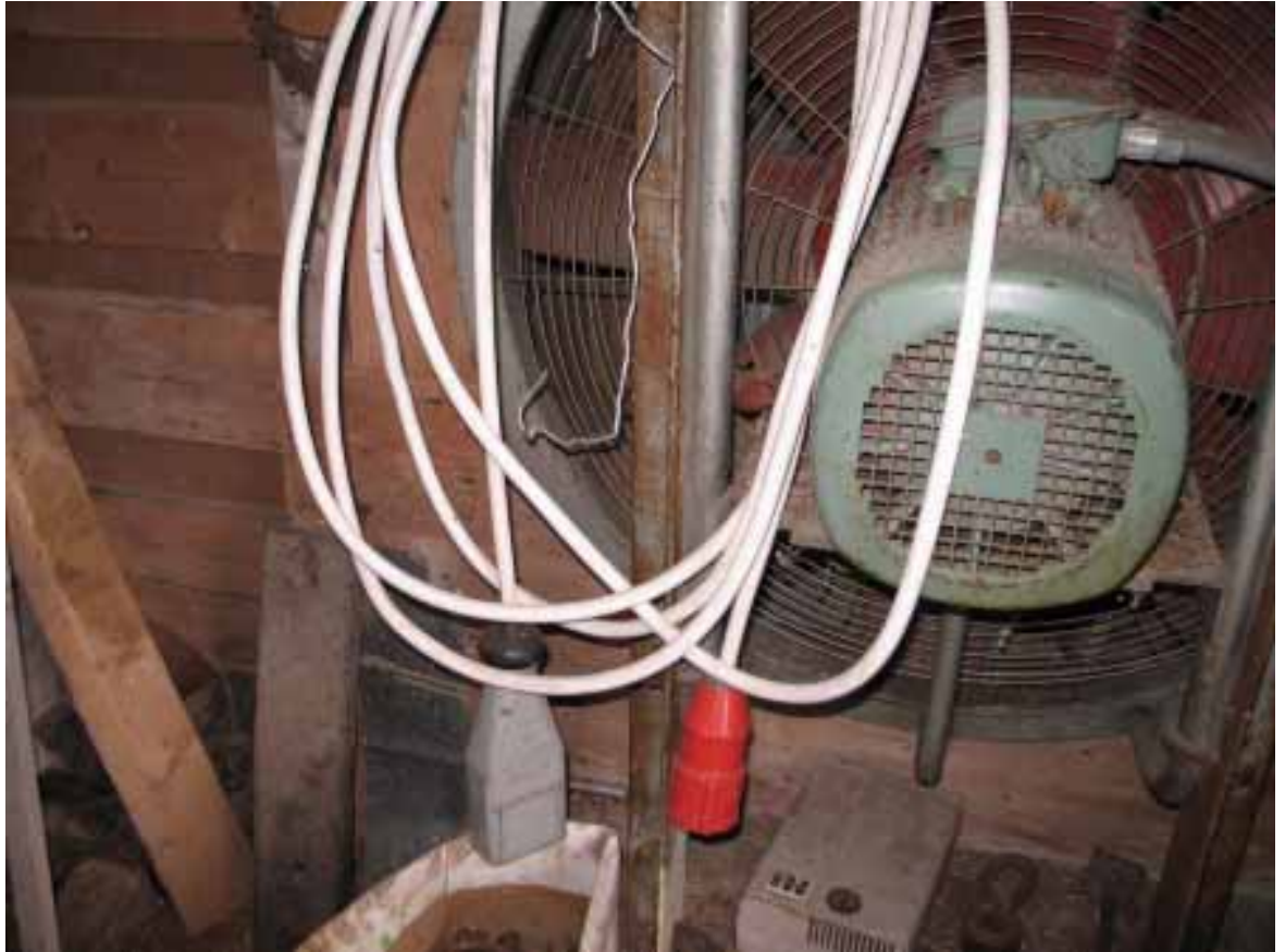
Kuva 14. Kiinteän asennuksen MMJ-kaapelia väärin käytettynä.
