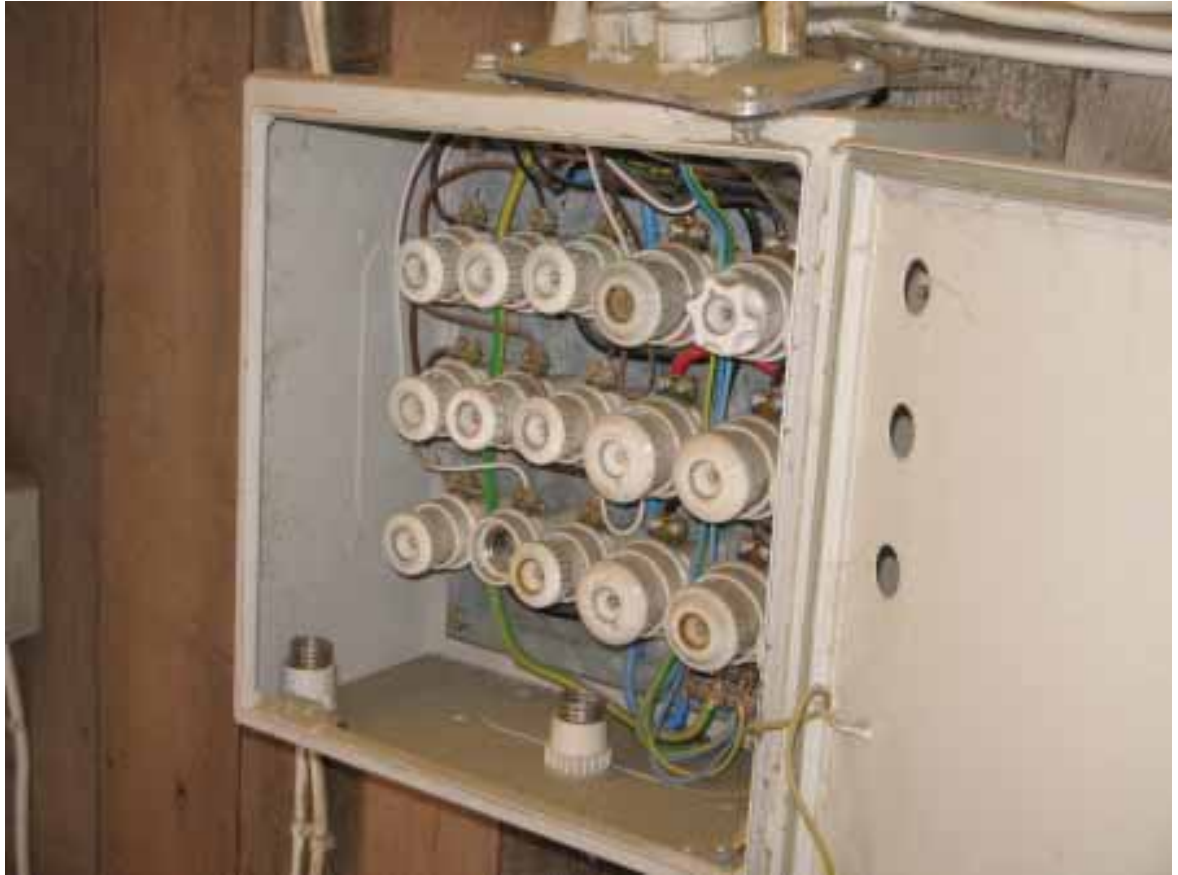
Kuva 9. Hengenvaarallinen keskus ilman jännitteisten osien kosketussuojia.
