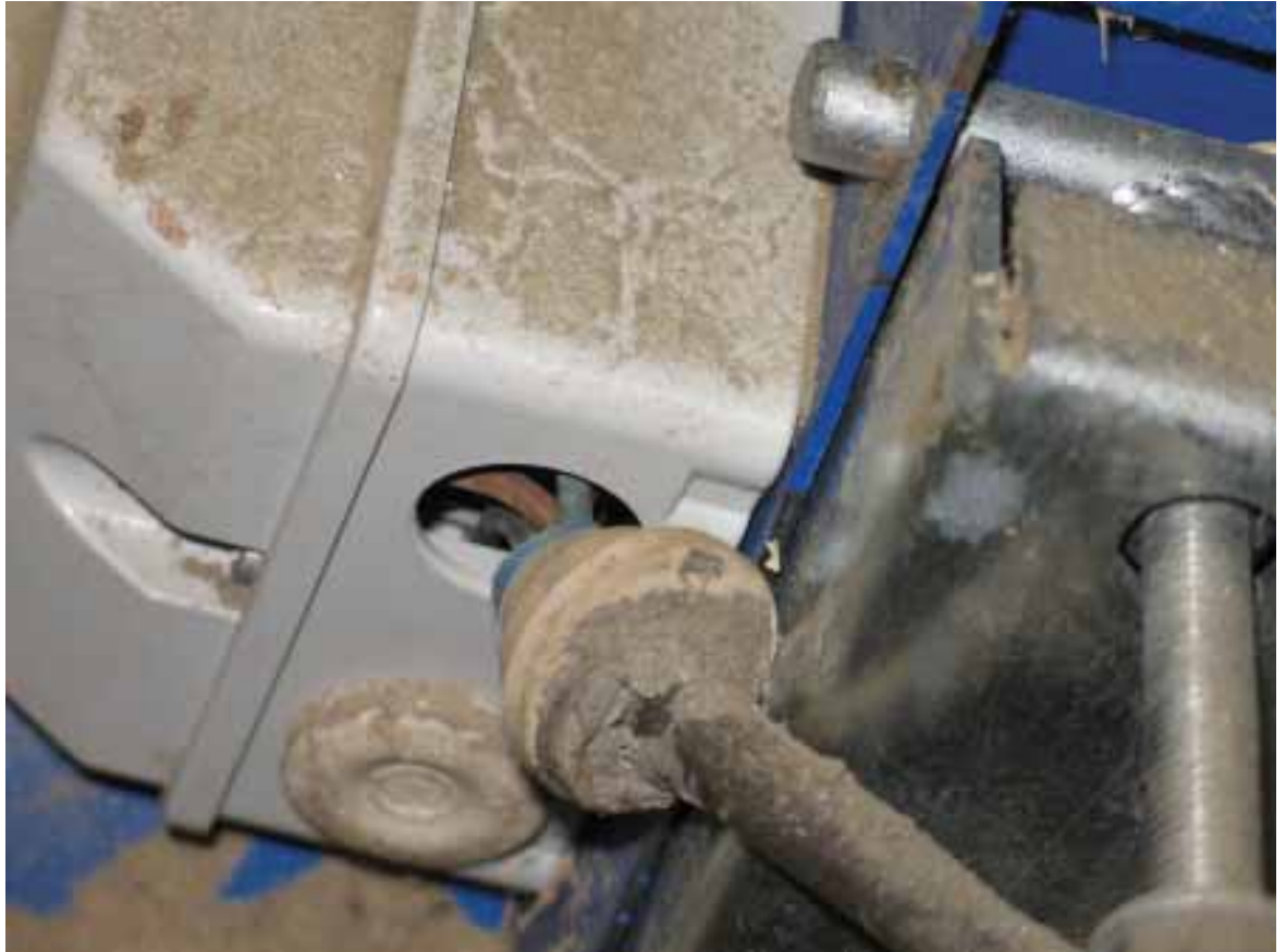
Kuva 6. Puutteellinen sähkökaapelin vedonpoisto.
