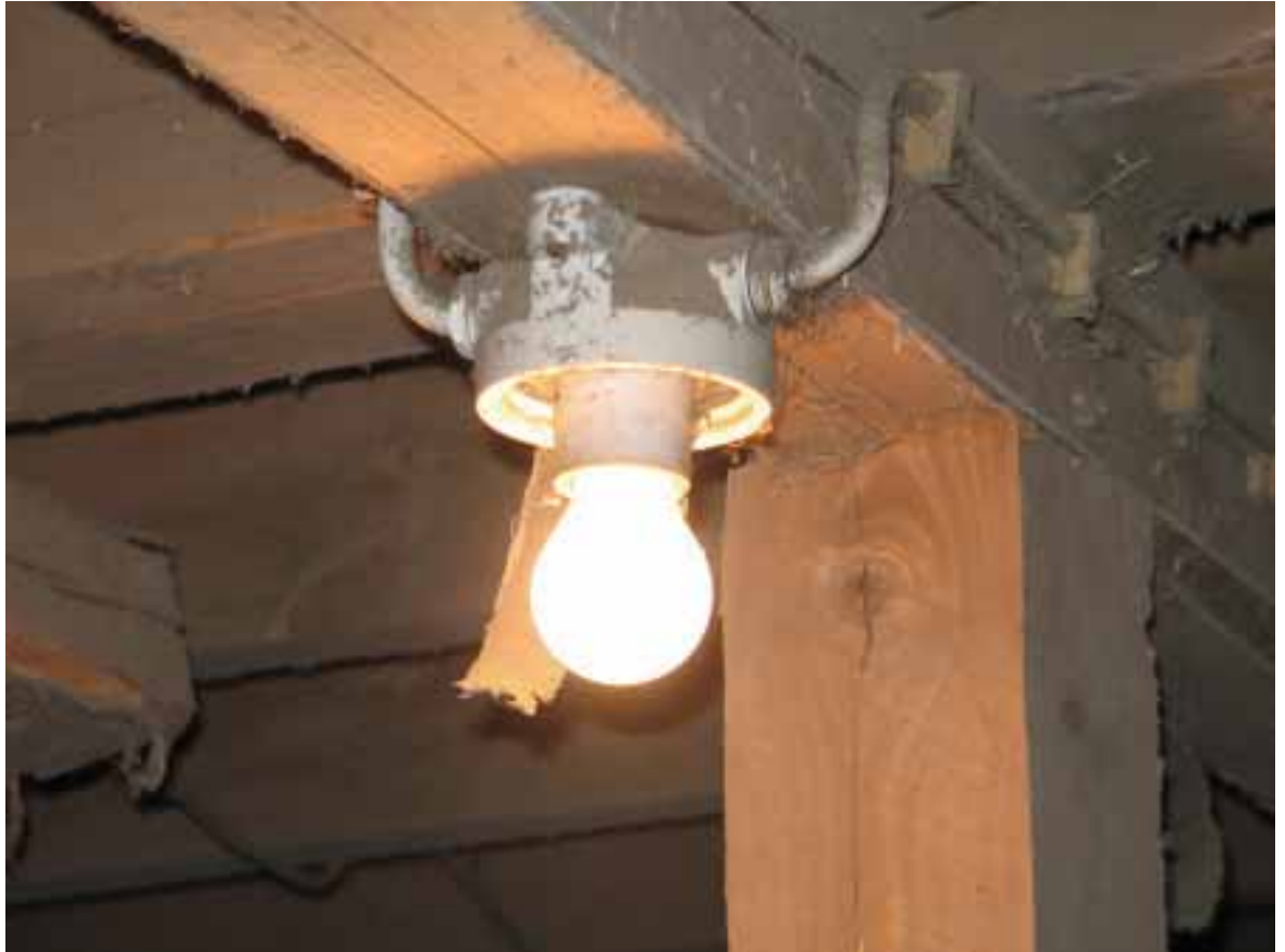
Kuva 18. Pölyinen hehkulamppu ilman suojakupua.
