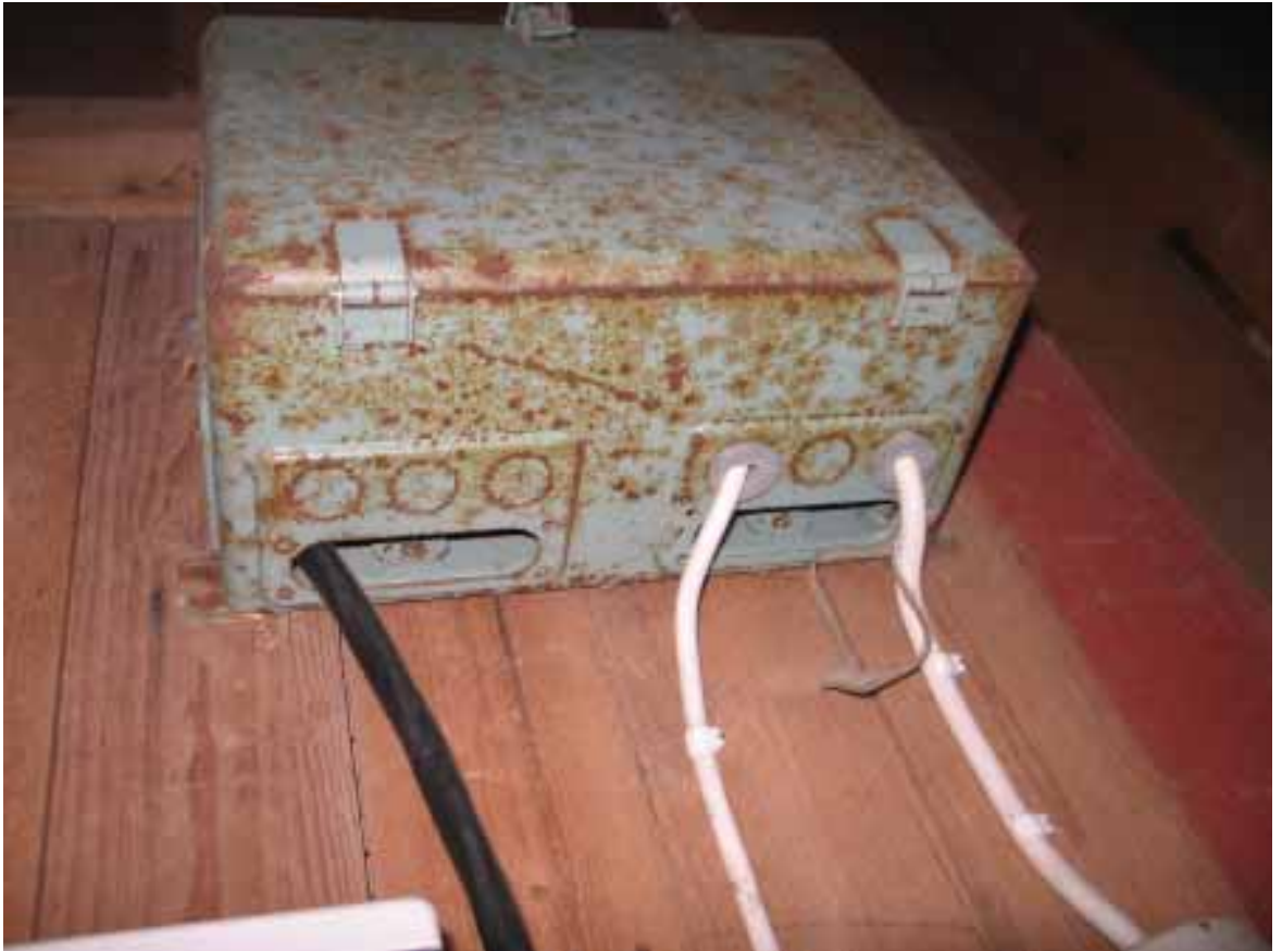
Kuva 7. Vääränlainen kaapelin vienti keskuksen.
