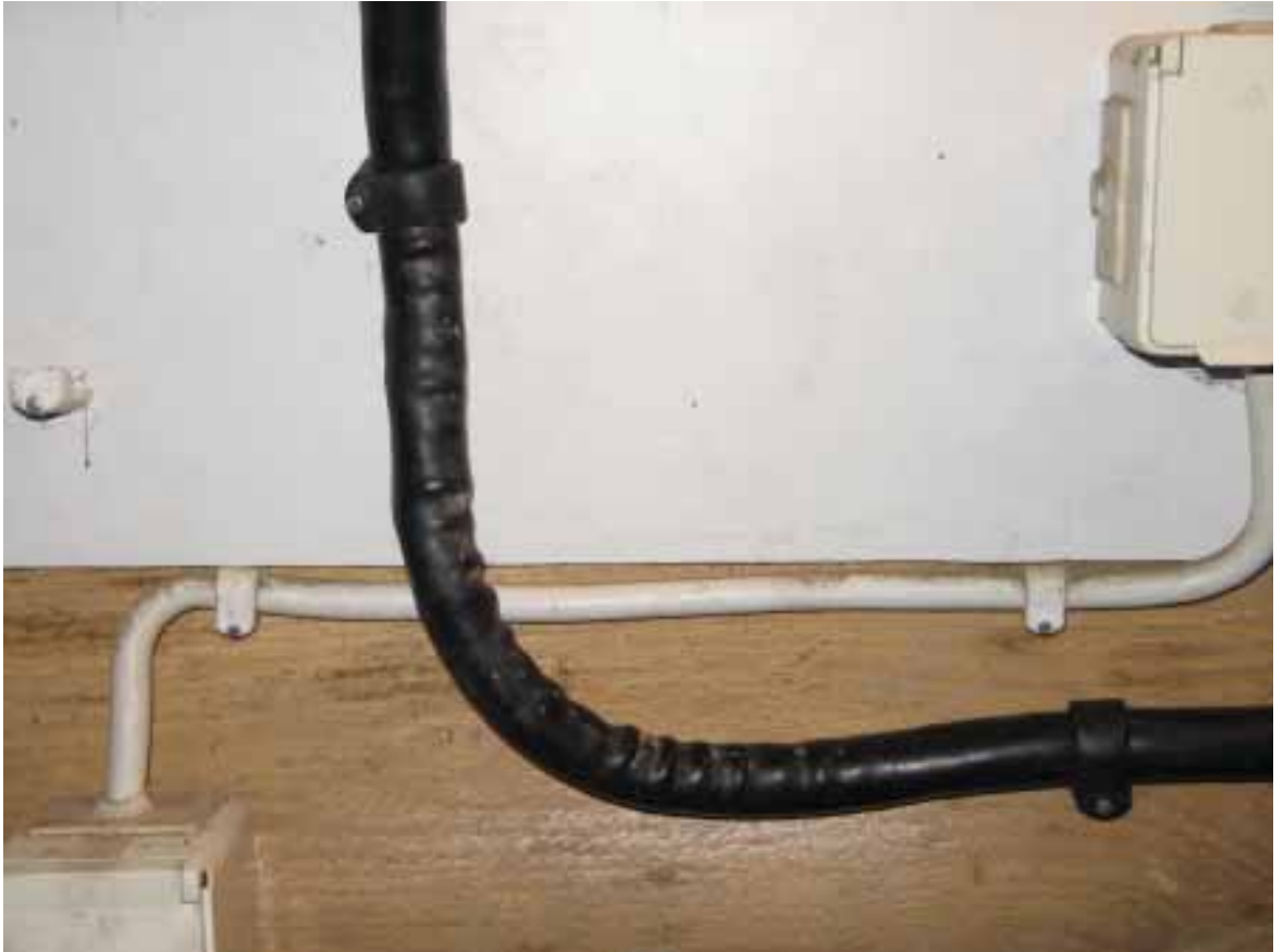
Kuva 21. Poimuilla oleva huolimattomasti käännetty kaapeli.
