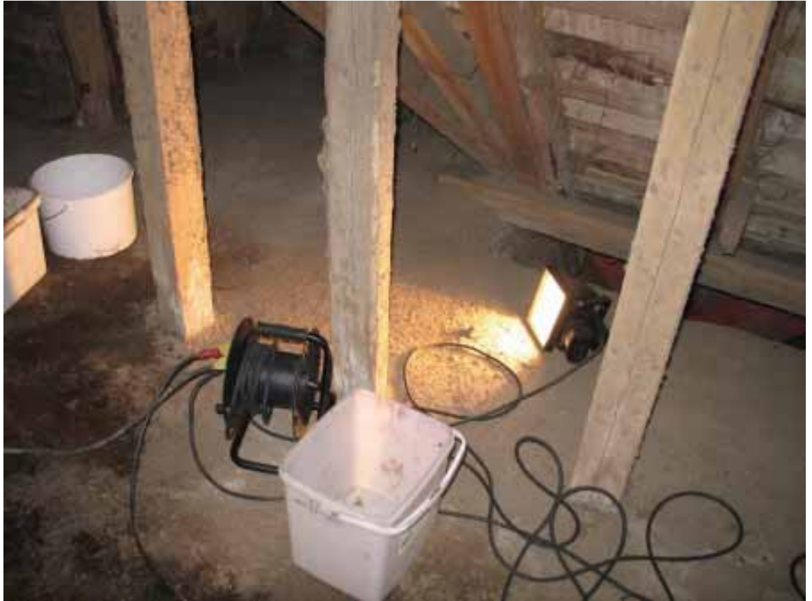
Kuva 16. Tilaluokitukseen sopimaton halogeenivalaisin.
