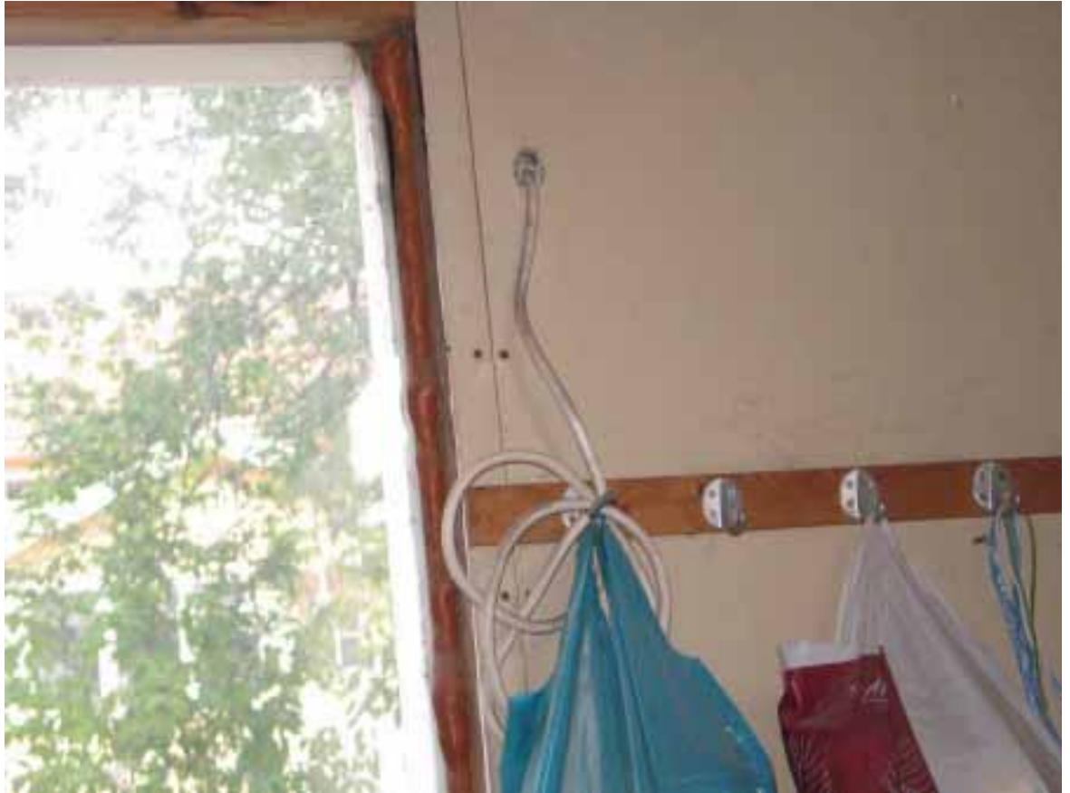
Kuva 23. Käytöstä poistettuja kaapeleita.
