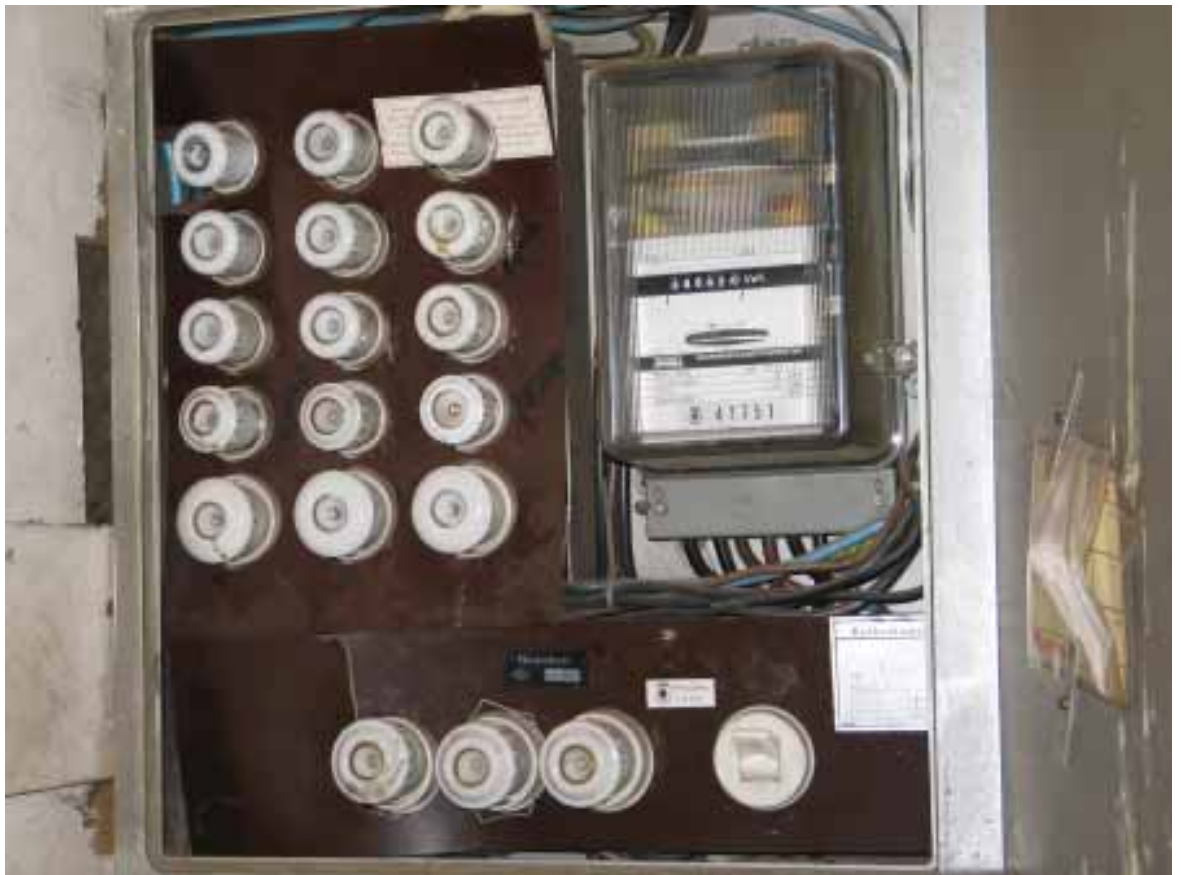
Kuva 10. Puutteellinen keskuksen osoitteistointi.
